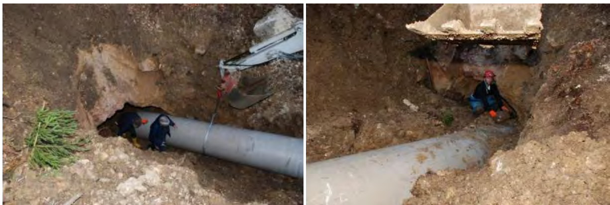
Rohreinpassung und Aufschlichtung im Bereich des Mundloches zur Deckenabstützung Fotos: Andreas LANGER
